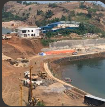
Lake Kivu Gas 76 MW
